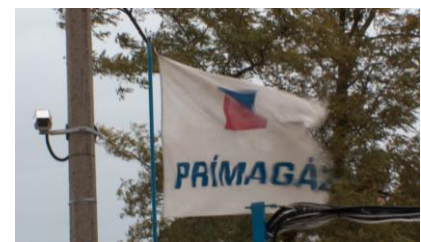
Prímagáz Zrt. Kültéri kamerarendszer, tűzjelzőrendszer
